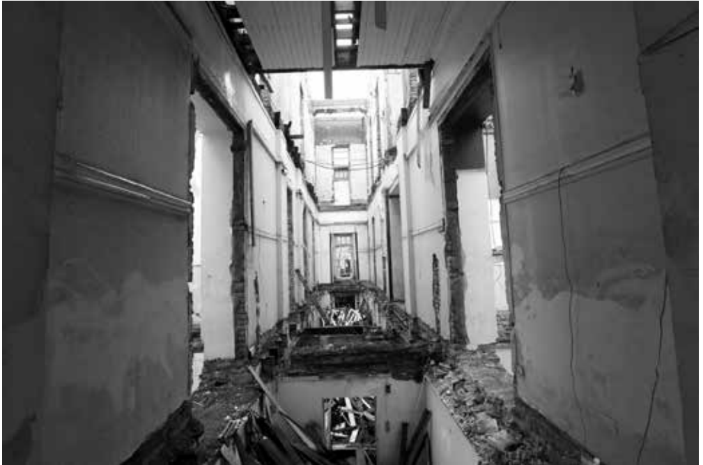
Estado actual del ex Cuartel Borgoño
